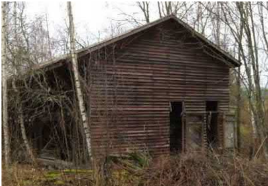
Lautatavaran myyntipiste/ taukotupa. Kuva: Kuhmoisten kunnan Satamarinteen rakennusinventointi, kohdekortit, Sweco Ympäristö Oy 15.11.2018
